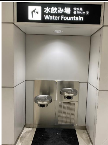
成田機場飲水設備
